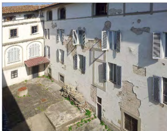
FOTO 1 Vista della corte del Complesso di San Giuseppe con le facciate da rivestire
